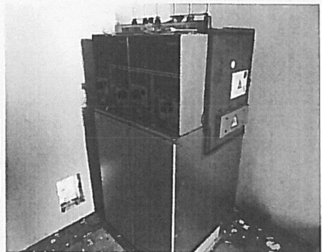
4 - Distribution Cellules de boucle 20 kV
